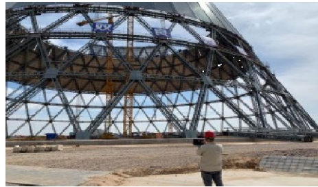
AR展示: 钢塔、锅炉等建筑物可视化展示
